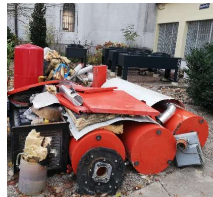
Das Ende der Gasheizung (2022)
